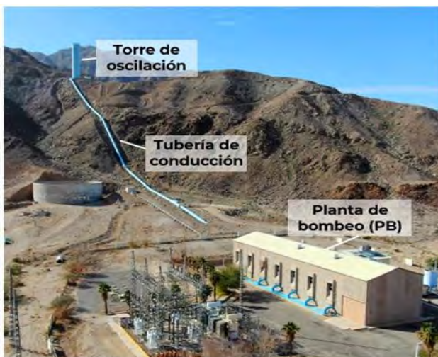
Figura 13. Principales componentes de una de las seis plantas de bombeo del Acueducto Río Colorado – Tijuana (ARCT)
